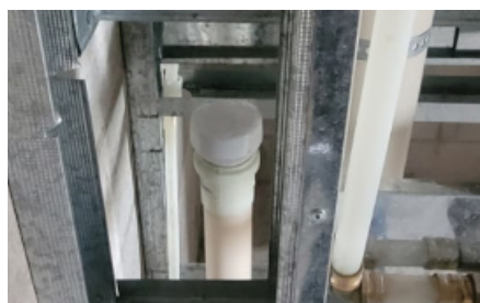
Interior de shafts hidráulicos
