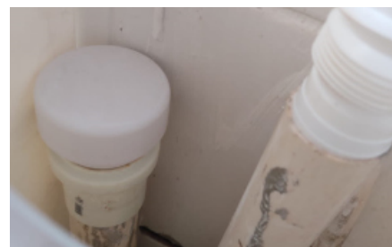
Interior de gabinetes
